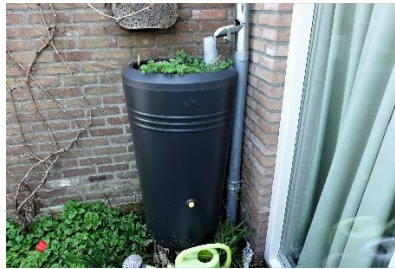
regenpijp met klep
